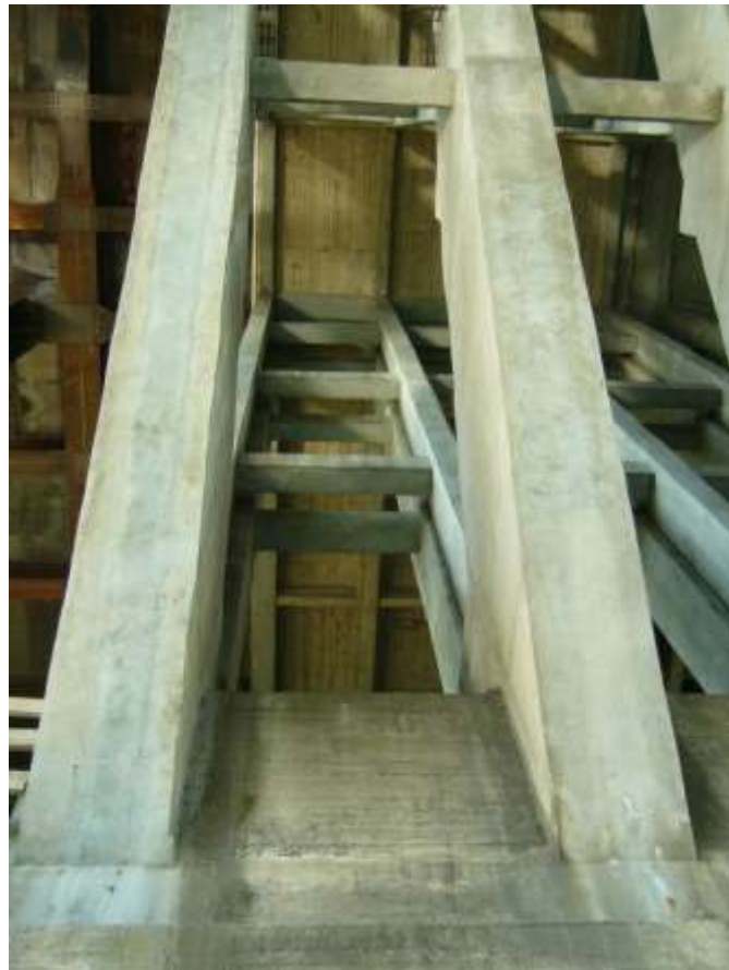
dettaglio di attacco degli archi e della pila con i suoi traversi
