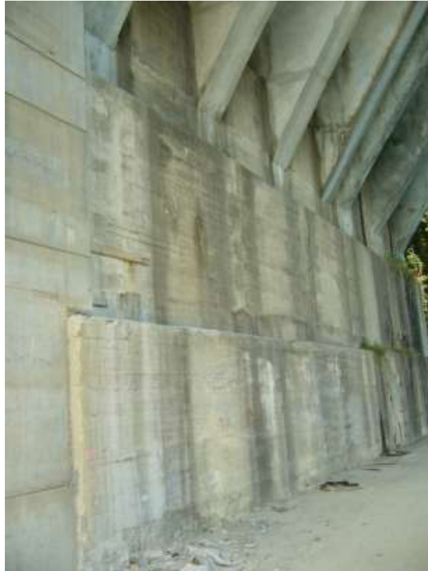
Dado di fondazione arco 2° ponte eseguito nell'anno 60 – Lato Milano - Foto del 2007 Notare i 3 archi per il ponte del 1927 ed i 4 archi in cls. per quello del 1960
