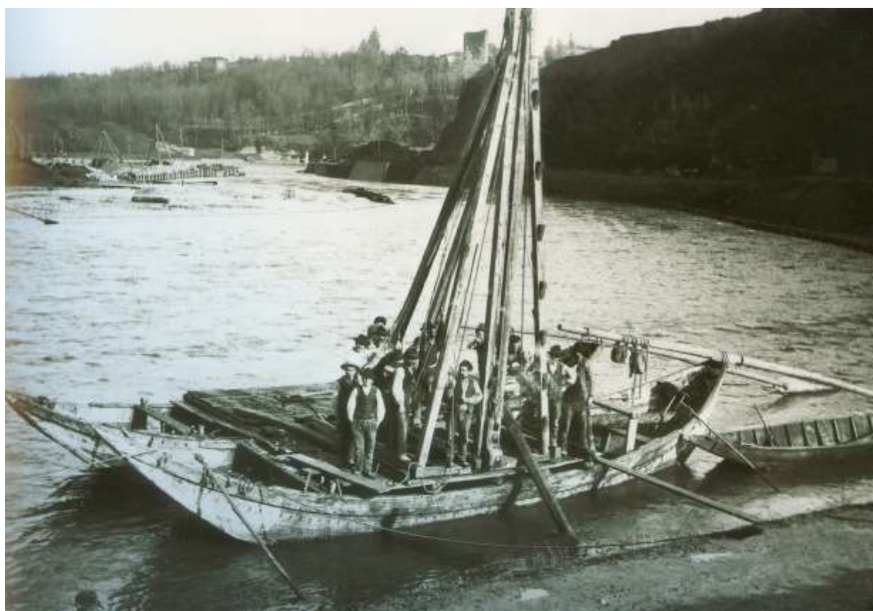
Barcone dal quale venivano infissi in acqua nel letto del fiume i pali di legno per realizzare la briglia di regolazione necessaria per alzare il livello dell'acqua a monte.
